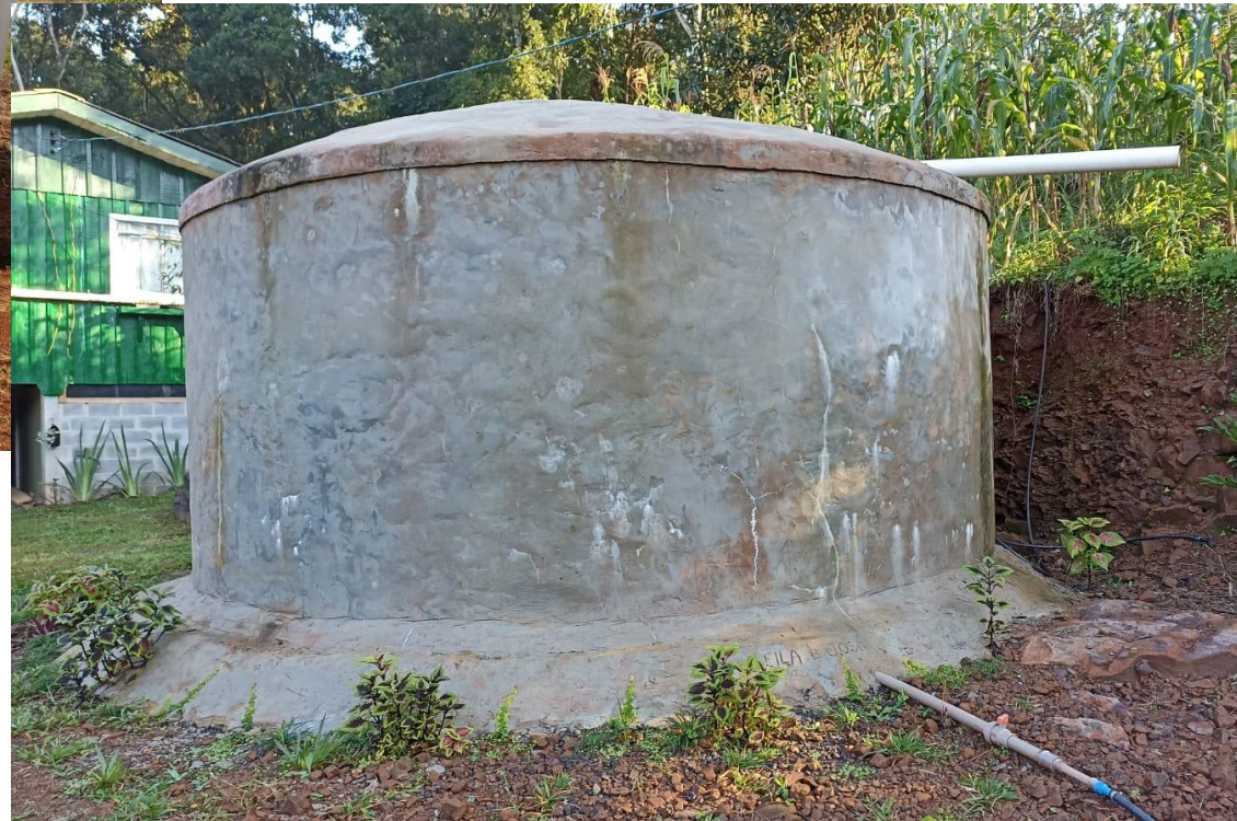
Cisterna para armazenamento de água da chuva (30 mil litros) Zisterne zur Speicherung von Regenwasser (30.000 Liter)
